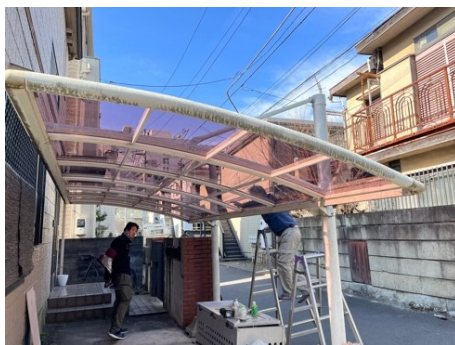
ひょう被害で屋根を張り替えたカーポート
