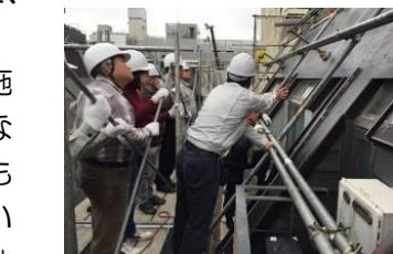
工事中の組合員現場見学会 斜め屋根部分の防水状況を見学
