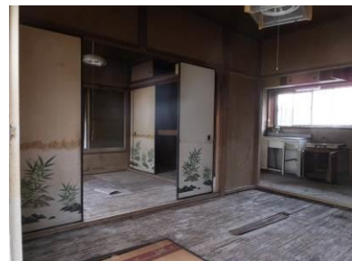
被災住宅 浸水状況は襖の線で見えます
