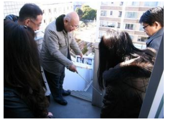
屋外階段の劣化状態を皆さんでチェック
